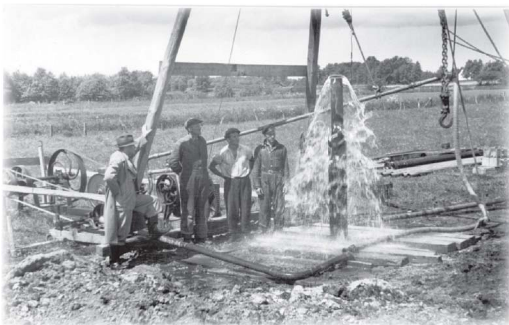
Figur 4: Figuren viser en artesiske boring ved Volderslev. Billedet er taget i 1939 i forbindelse med forundersøgelserne inden etableringen af Lindved Kildeplads. 2. verdenskrig satte en midlertidig stopper for anlægsarbejdet og derfor kunne Lindved Kildeplads først sættes i drift i 1948.
