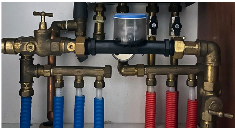
Korrekt monteret måler. Bemærk kontrollerbar kontraventil i målerforskrning, kategori 2.
